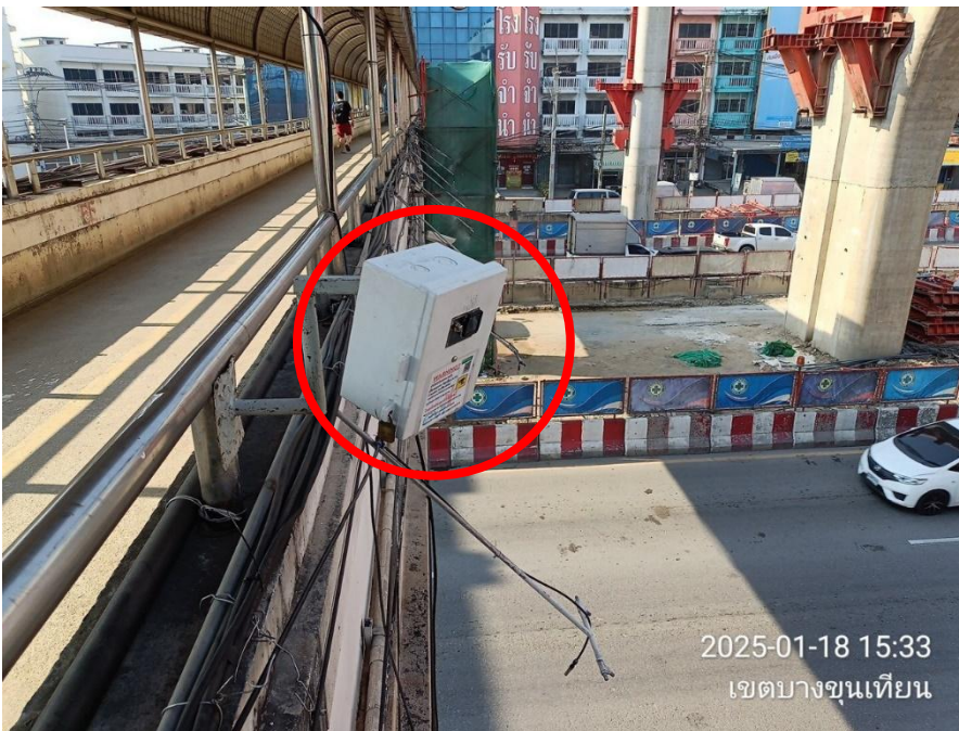
จุดที่ 1 ถนนพระรามที่ 2 บริเวณซอย 82 กม.11+250
