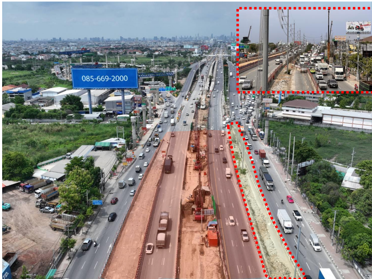
3 อุปสรรคแนวเสาและสายไฟฟ้า 69 kV ของ กปน. ที่ต้องรื้อย้ายให้แล้วเสร็จก่อนเข้าพื้นที่เพื่อทำการก่อสร้างได้ตามแบบ
