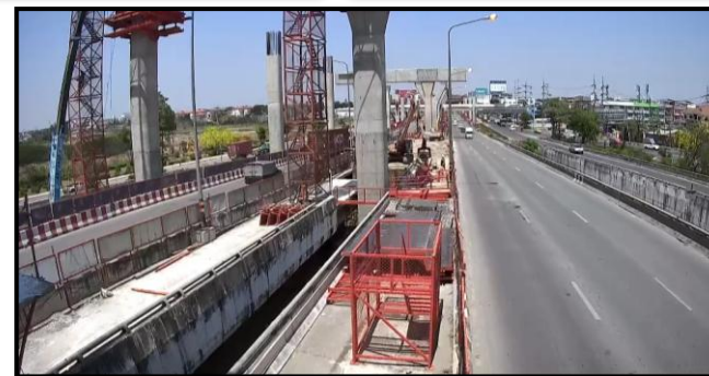
ภาพจาก กล้อง CCTV บริเวณที่ตรวจติดตามพฤติกรรมโครงสร้างสะพาน
