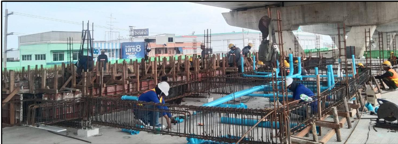
งานก่อสร้างอาคาร Rescue Substation Building (Ramp 2)
