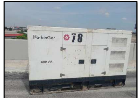
เตรียมเครื่อง Generator ให้พร้อมใช้งาน
