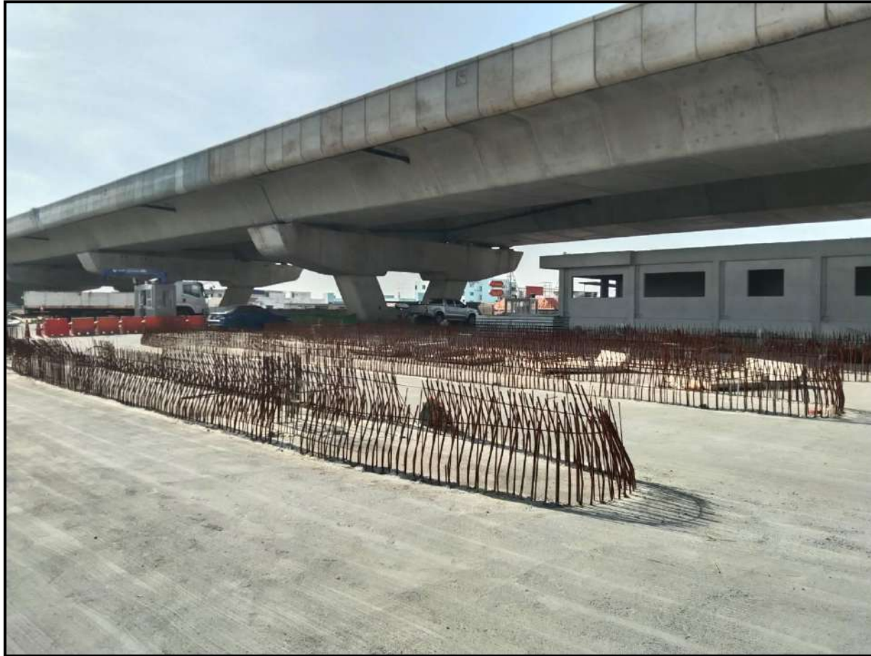
งานก่อสร้าง Toll Canopy - ด้านบางขุนเทียน
